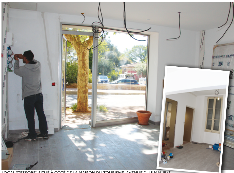
LOCAL "TESSORE" SITUÉ À CÔTÉ DE LA MAISON DU TOURISME, AVENUE DU 8 MAI 1945.
