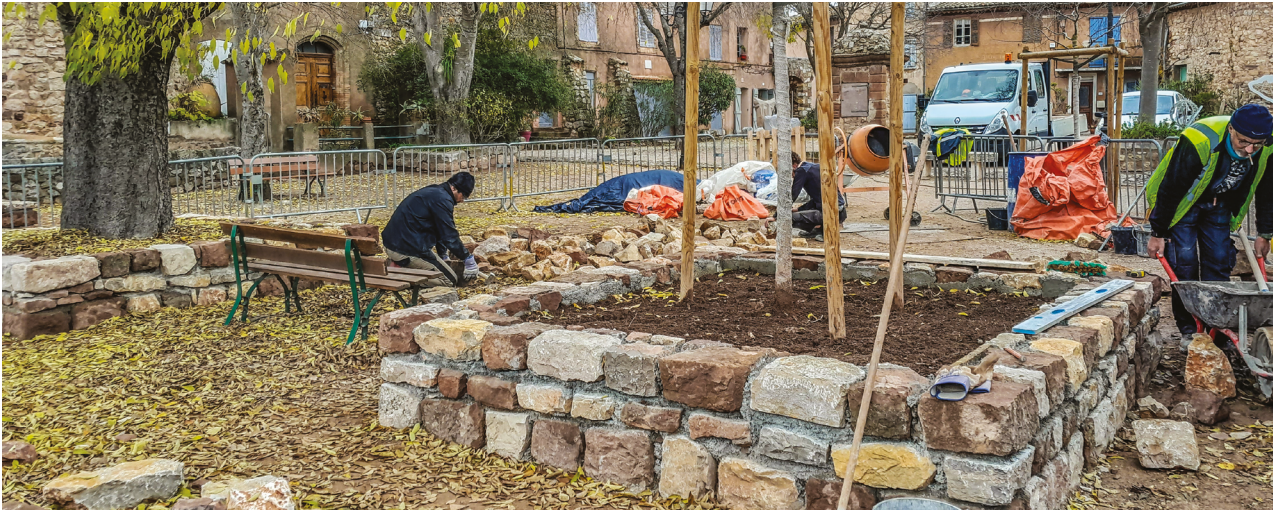
LES TRAVAUX CONDUITS PAR L'ASSOCIATION ADESS ONT EU LIEU DE NOVEMBRE À JANVIER SUR LA PLACE DES MICOCOULIERS.
