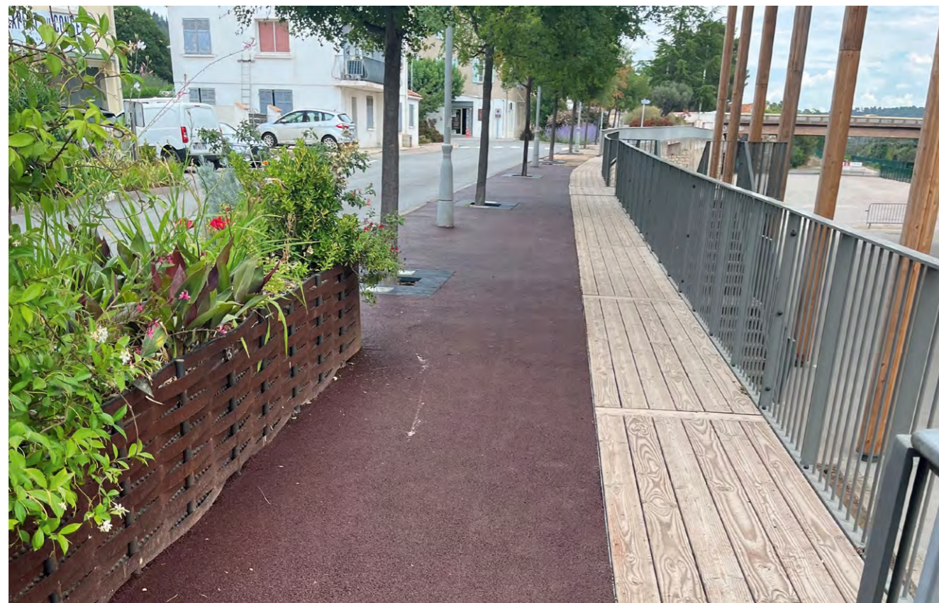
Réfection des trottoirs situés face aux Terrasses de la Gare en centre-ville
