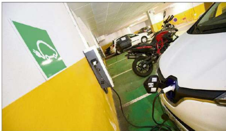
La ville de Draguignan a installé cinq bornes au parking Victoire. D'autres sont en prévision au parking de l'îlot de l'Horloge, celui des Musées et aux allées d'Azémar. (Photo Clément Tiberghien)
